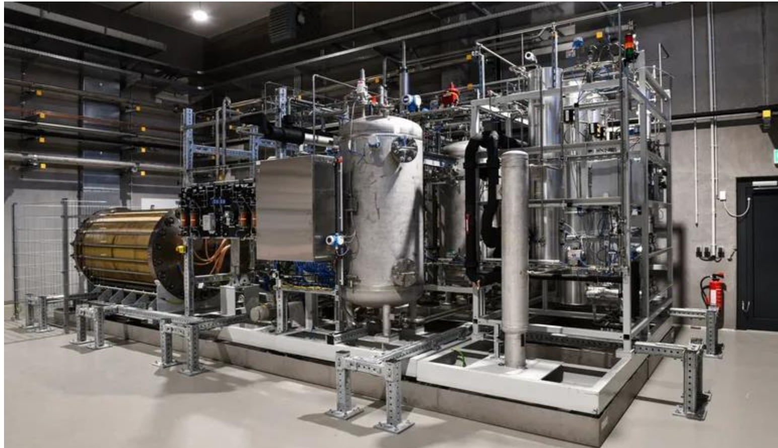
Elektrolyseur mit Reinigungs- und Trocknungsanlage der Power-to-Gas-Anlage der EnBW in Grenzach-Wyhlen (Foto: EnBW) | Quelle: https://www.enbw.com/unternehmen/themen/wasserstoff/gruener-wasserstoff.html
